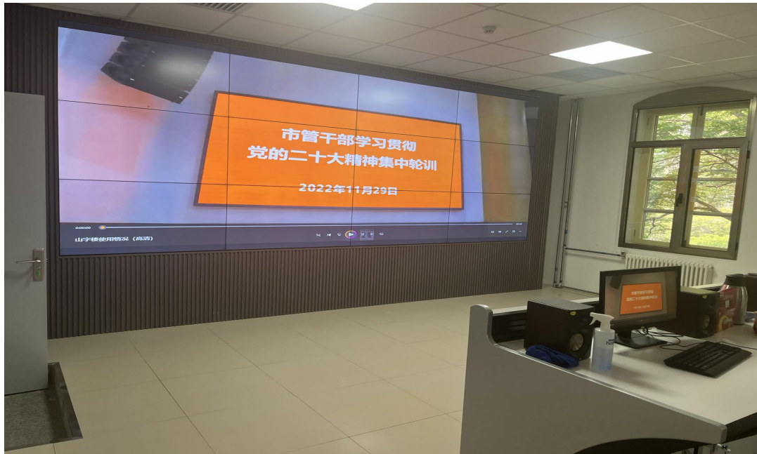
图 2：山字楼智慧教室中控室相关多媒体设备
